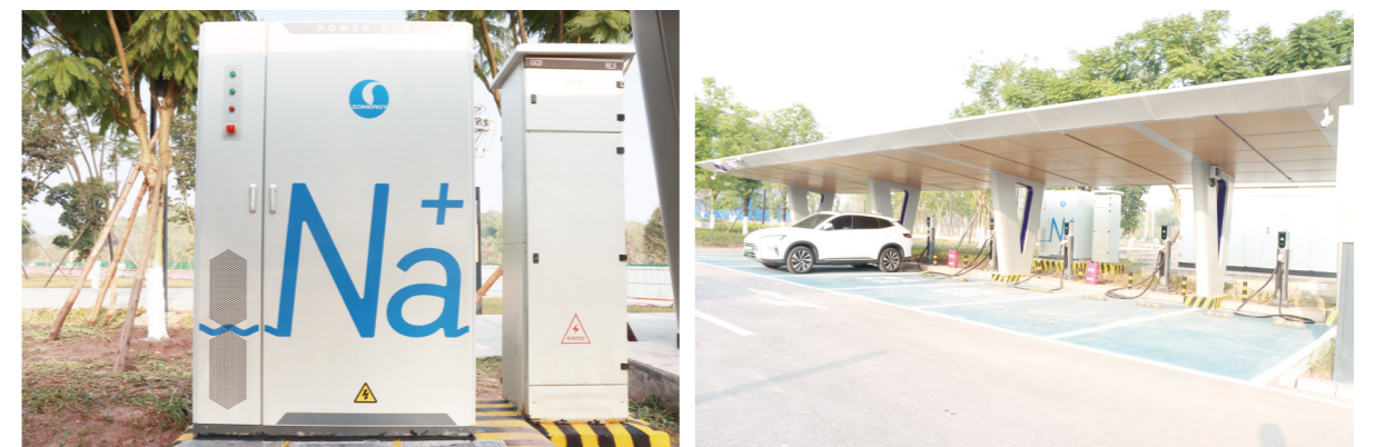
2023年底，公司500kW/1MWh光储充一体化示范项目一期工程50kW/105kWh正式在自贡投运。是四川省首个成功投运的钠电储能示范项目。
