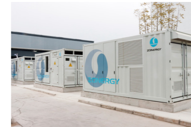
工商业园区储能
