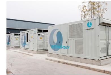
工商业园区储能
